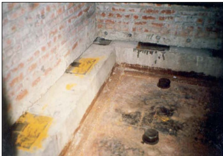
Slika 184: Pogled na zdrs modela na mestu drsnega sistema izolacije Fig. 184: View of the displaced bearings
