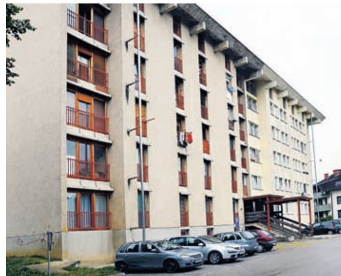
Ob Vojkovi cesti je občinska večstanovanjska stavba, ki je res potrebna prenove. Polovica ima še stara okna, ki energetske niso varčna. Celovita obnova bo na vrsti naslednje leto.
