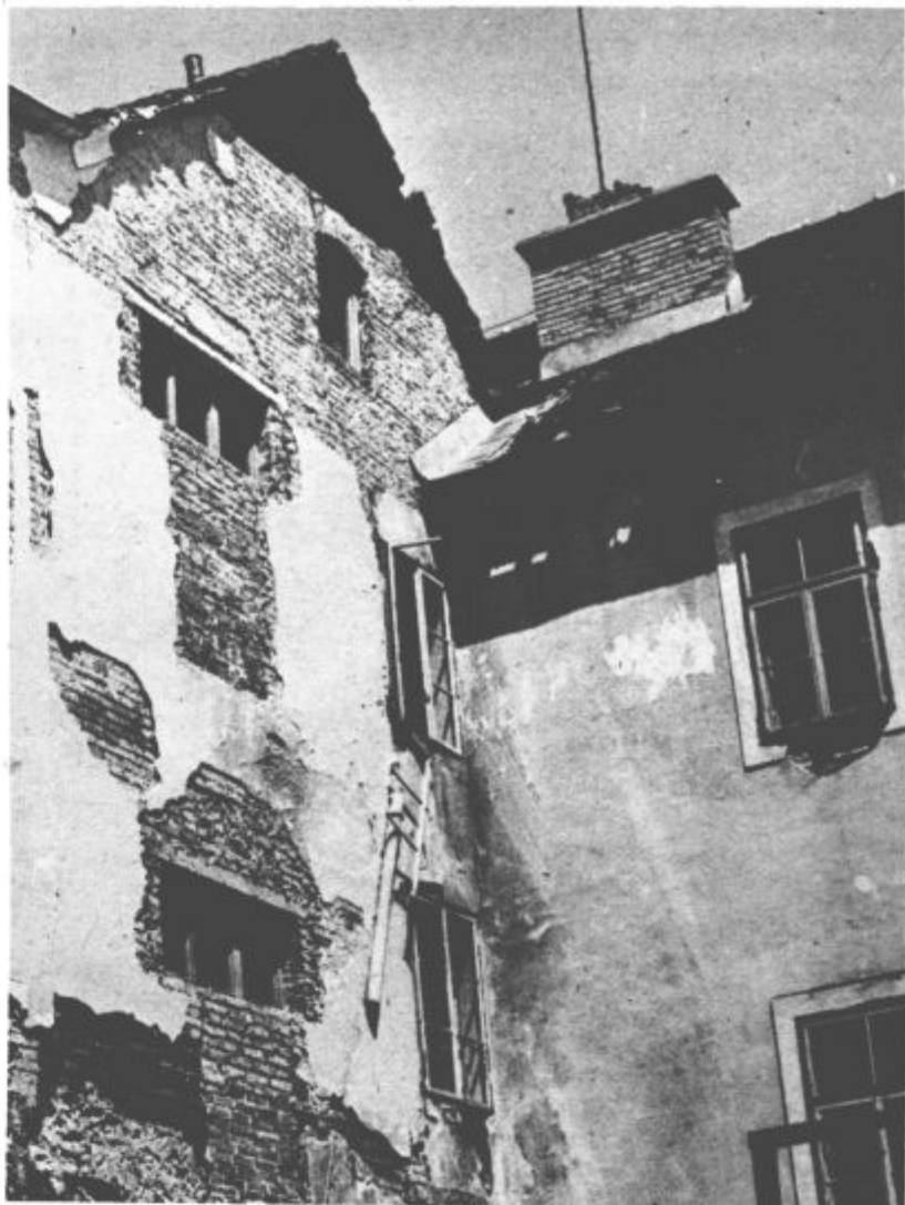
Potresni sunki so zamajali stene stare šole v Zibiki. Razpoke povsod nevarno grozijo.
