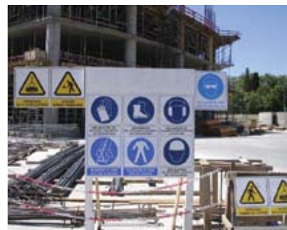
Slika 11: Primer table, ki opozarja na uporabo osebne varovalne opreme (vir: http://www.oitcinterfor.org )
