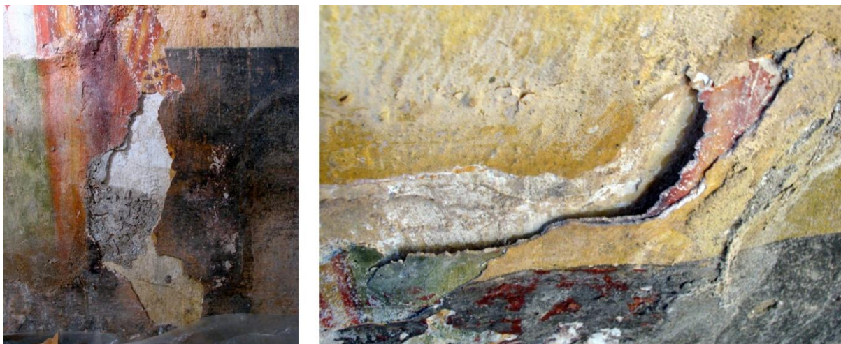
Slika 2.6: Godešič, cerkev sv. Miklavža, odpadanje in odstopanje ometa zaradi delovanja kapilarne vlage (levo). Detajl odstopajoče plasti ometa od stene (desno) (Kavčič, 2008).
