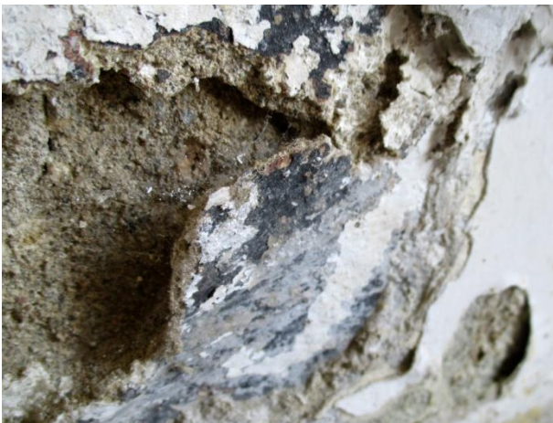
Notranjost – rdeča puščica kaže na odstopanje ometa zaradi prekomerne vlage (1 m od tal)
