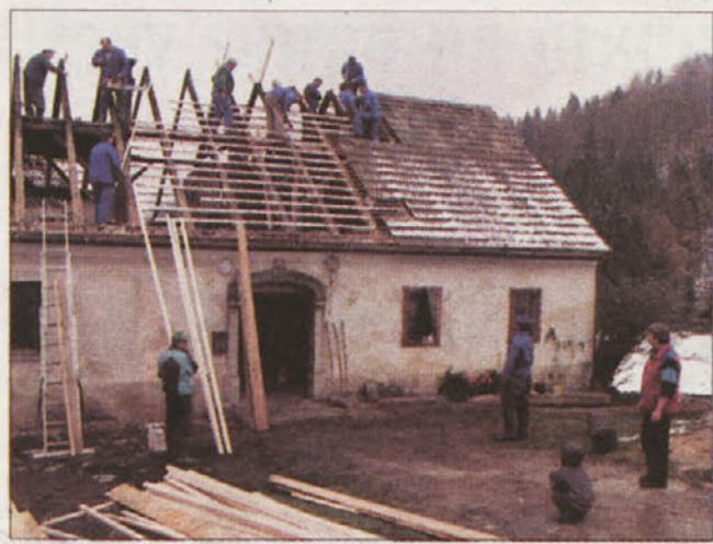
POŽAR PRI ZIDARIČEVH - Vaščani so s prostovoljnim delom (na posnetku) pred prezgodnjo zimo zaščitili hišo Zidaričevih. Zamenjali so late in strešnike, ko bo vreme lepše in denar, bodo zamenjali še del ostrešja, predvsem pa v požaru, ki se je razširil iz dimnika, v katerem so se vžgale saje, močno zoglele špirovce. (Foto: P. Perc)
