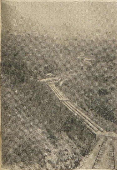
Cevovod s strojnico HE Periyar. Prostor za četrti cevovod je do bro viden
