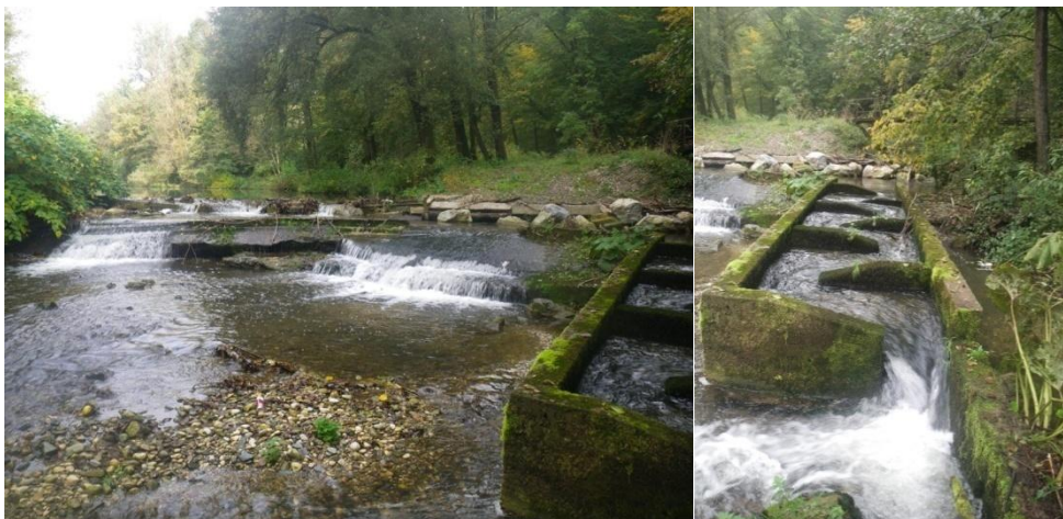
Slika 77: Pregrada na izlivnem delu Gameljščice, pri ribiškem domu (levo) in ribja steza (desno).
