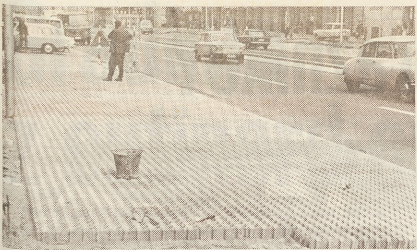
Polovica parkirnih prostorov v Cvijičevi ulici v Beogradu je že tlakovanih z Gradisovimi travnatimi ploščami
