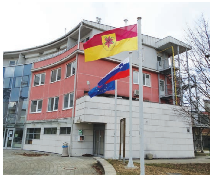
Dvorana Marjanca Ručigaj in kletni prostori Mladinskega kluba v Centru Ivana Hribarja sta v zaključni fazi obnove.
