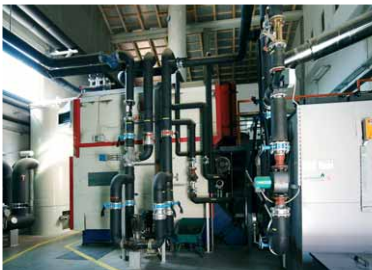
Kotlovnica v Revitalu
