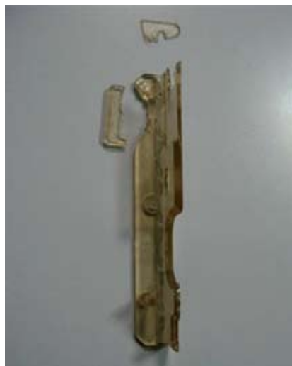
Slika 4: Poškodba varnostnega stikala na jaškovnih vratih malega tovornega dvigala
