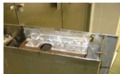
Slika 3: Varnostno stikalo na jaškovnih vratih malega tovornega dvigala
