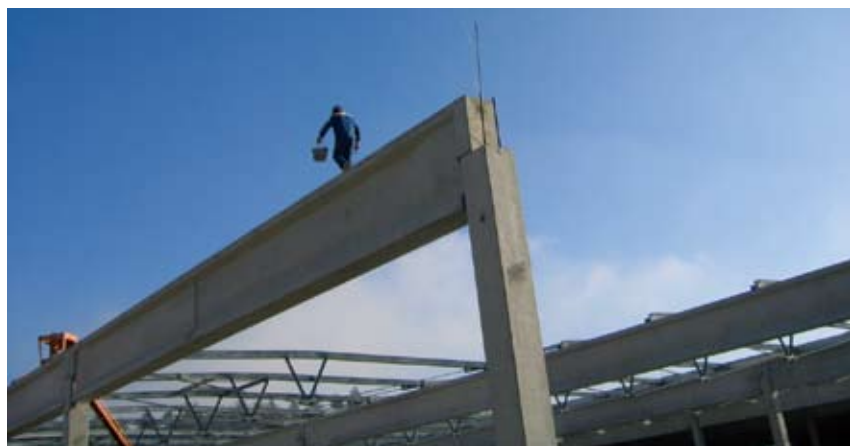
Prikaz neprimerne delo na gradbišču
