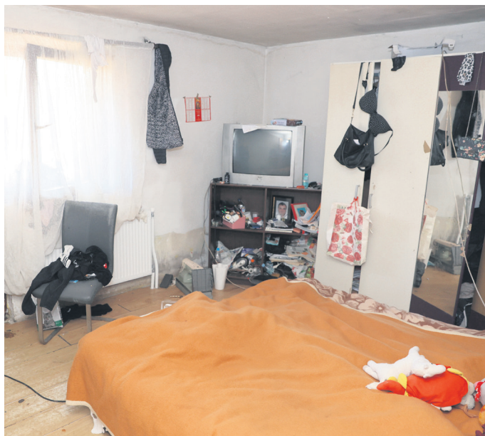
V spalnici zaradi vlage odpada omet.
