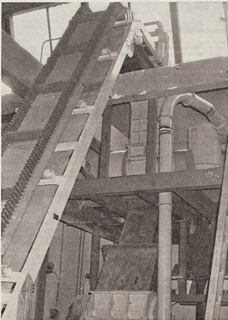
Realizacija razvojno-inovacijskega projekta »Predelava odpadne gume« v fazi montaže v valjarni TTI
