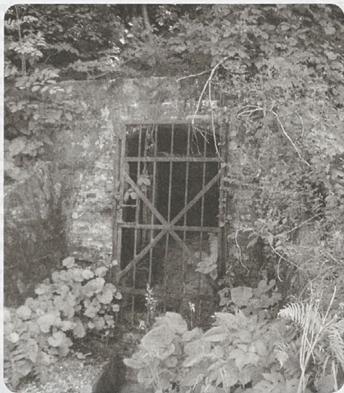
Izvozni savski rov: za vrati in betonsko pregrado so velike količine vode in mulja.
