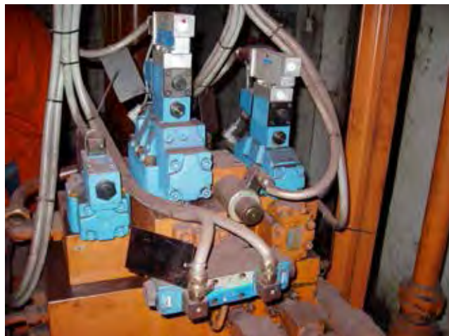
Slika 3 : Eden od številnih ventilskih blokov hidrauličnega sistema (HS) – postrojenje Steckel v vroči valjarni, SIJ Acroni
