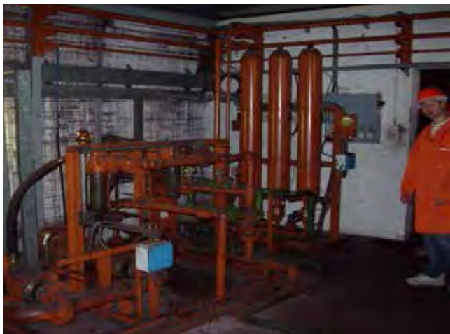
Slika 2 : Del hidrauličnega sistema (HS) s hidrauličnimi akumulatorji (HA) – Vroča valjarna, SIJ Acroni
