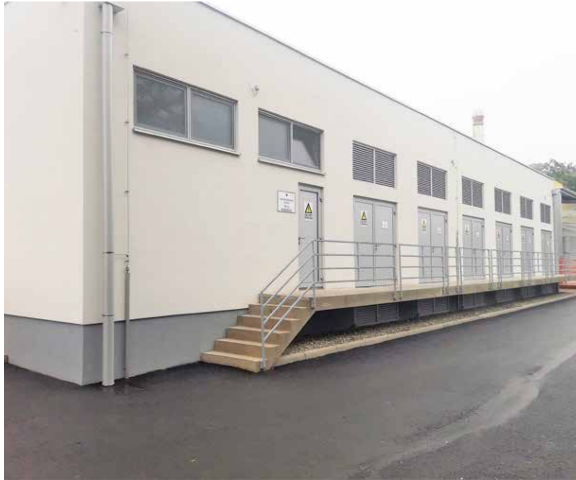
Transformatorska postaja TP11 Rondelice
