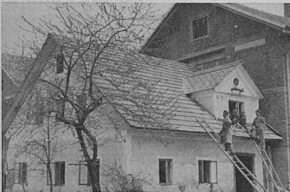
Francu Erženu je potekel dopust delovno. Stara hiša, ki jo vidimo na sliki je podrta in prostor splaniran, nova (zraven stare) pa ima ometano fasado. Kaj ni lahko zadovoljen?
