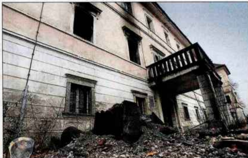
Požar v Lazarinijevem dvorcu, ki je po navedbah policije povzročil za dva milijona evrov škodo, je podtaknil nekdanji gojenec Vzgojnega zavoda Smlednik. / Foto: Tina Dokl (arhiv)
