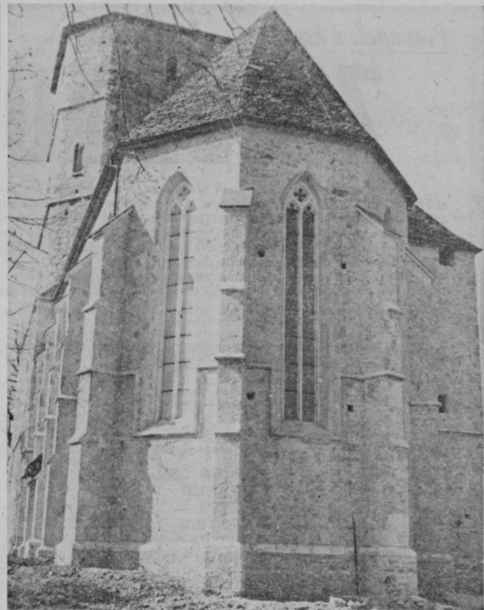
Facade ni. Vse je sam kamen. Zdajšnja podoba se ne more primerjati s tisto pred obnovitvenimi deli. Posnetek prikazuje obnovljena gotška okna, ki so mojstrsko delo kamnoseštva. Lepo so vidni tudi oporniki, značilni za gotško arhitekturo. Na njih slonijo oporniki, ki jih vežejo sklepniki. V tem je značilnost gotške arhitekture, ker stene ne nosijo obremenitve, si gotika lahko dovoli izredno visoka in velika okna.
