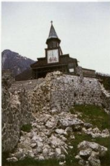
Sl. 23. Cerkev na Javorci je vzdržala brez poškodb, medtem ko so bili kamniti zidovi večinoma porušeni, kar potrjuje ocenjeno VI. stopnjo po EMS.
