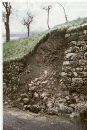
Sl. 21. Številni podrti kamniti podporni zidovi, kot je primer iz Drežnice, so značilni za VI. stopnjo EMS.
