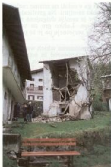
Sl. 42. Delna porušitev stene objekta iz neobdelanega kamna z lesenimi stropovi (poškodbe 4. kategorije) je značilna za VII. - VIII. stopnjo EMS. Tudi ta porušitev zgradbe v vasi Magozd je posledica delovanja nepovezanega zidovja.
