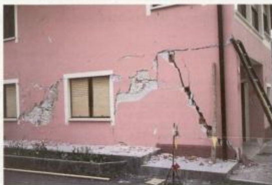
Sl. 44. Globoke razpoke v konstruktivnih in nekonstruktivnih elementih novejšega stanovanjskega objekta, grajenega iz opeke z armiranobetonskimi (AB) stropovi so značilne za VII. - VIII. stopnjo EMS. Omenjene poškodbe 4. kategorije so nastale na številnih objektih v Mali vasi pri Bovecu.
