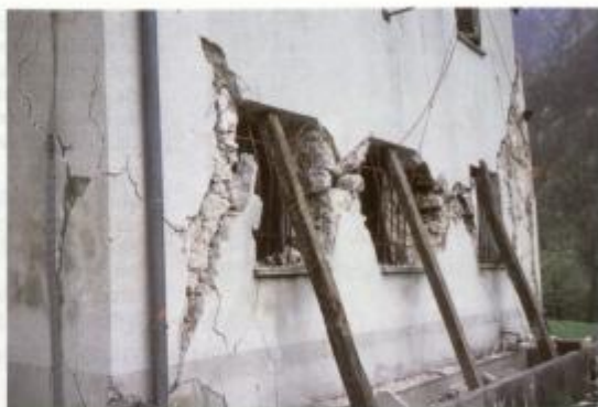
Sl. 43. Globoke razpoke v vseh nosilnih stenah in delna porušitev vogalov konstrukcije (poškodbe 4. kategorije) so značilne poškodbe objektov iz neobdelanega kamna pri VII. - VIII. stopnji EMS. Zaradi posedanja etaže so se porušile vse predelne stene v pritličju. Primer sirarne na planini Polog nad Tolminko v neposredni bližini Osojnice.
