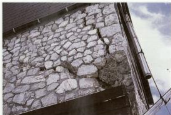
Sl. 26. Zmerne do hude poškodbe (3. kategorije), predvsem velike in globoke razpoke v stenah grajenih iz neobdelanega kamna, so nastale v SKI hotelu na Voglu in so značilne za VI - VII. stopnjo EMS.
