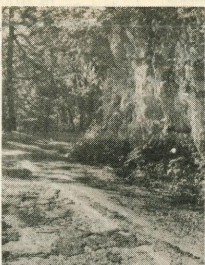
Cesta na Šmarjetno goro propada. Zaraščata jo grmovje in gozd, slabo je varovana in zato nevarna. Ob urejevanju Šmarjetne gore bo treba pomisliti tudi nanjo.
