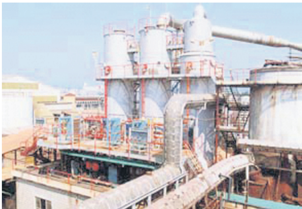
Ferosulfatna linija za proizvodnjo žveplove kisline
