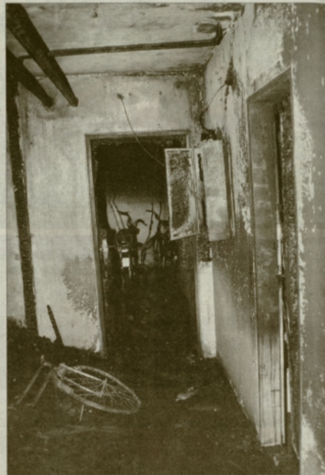
V Ulici bratov Vošnjakov so ljudje odstranili požarne stopnice z balkonov. Na srečo je bil zadnji požar omejen na klet.
