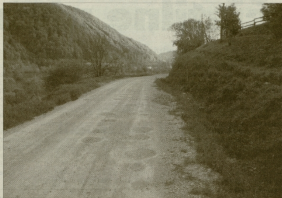
Namesto asfalta in široke ceste - luknje in prah.
