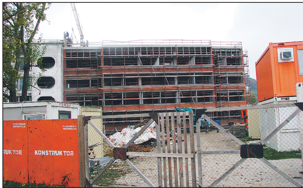
Z zadnje strani so bolnišnico že dozidali, zdaj postopoma obnavljajo star otroški oddelek.
