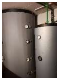
SLIKA 2: 1500-litrski hranilnik toplote, ob njem pa še bojler sanitarne vode s prostornino 300 litrov.
