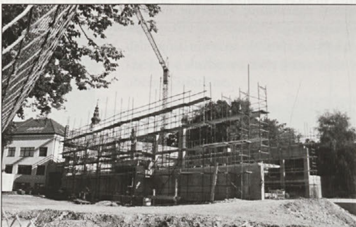
Pri osnovni šoli v Cirkulanah je odprto večje gradbišče. Do zime naj bi gradbeniki pod streho spravili novo večnamensko turistično-prireditveno dvorano.
