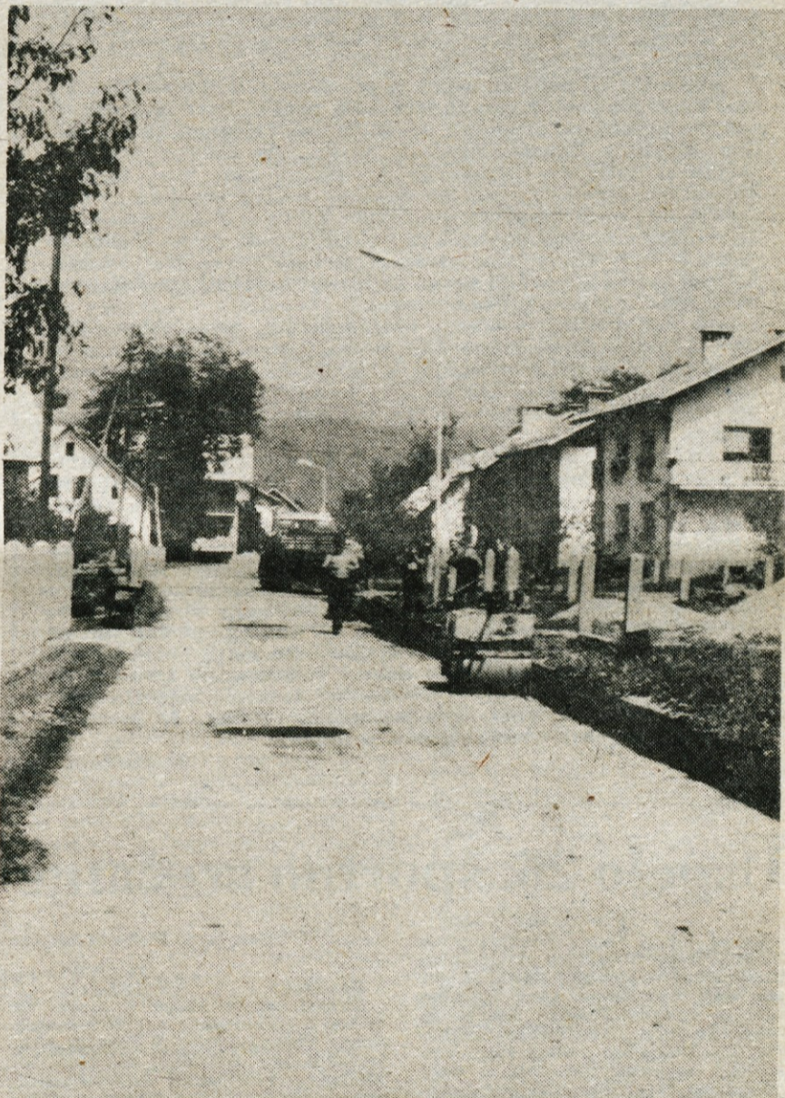
Srednja vas - Potem ko so v Srednji vasi in Šenčurju obnovili vodovodno omrežje, so krepko razdejali asfalt na cesti. Dela potekajo že lep čas in toliko časa je oviran tudi promet. Ta prilika bi bila sicer idealna za popolno sanacijo ceste, morda za novo asfaltno prevleko, toda zaradi denarne suše so prisiljeni le krpati stare razpoke. - Foto: D. Ž.
