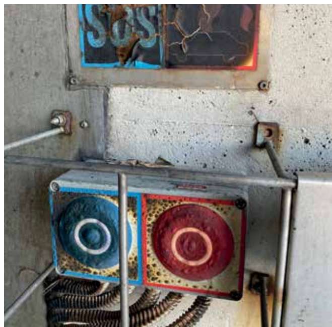
Slika 3: Visoke temperature so poškodovale predor.
