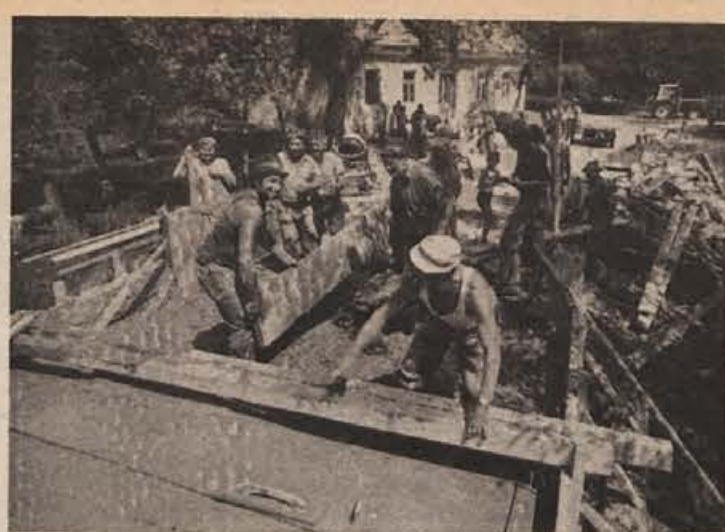
200 vreč cementa, 2 tona železa, 1000 delovnih ur in 16 parov pridnih rok je dovolj, da se zgradi nov betonski mostič. Na sliki: vaščani Zavinka pri Škocjanu pri delu. (Foto: S. MIKULAN)
