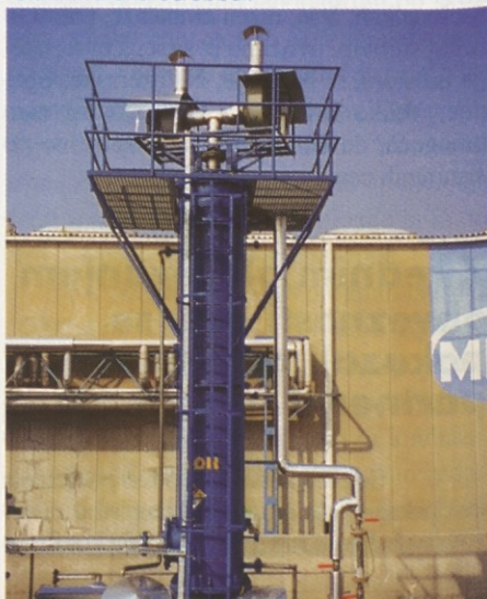
Čistilnik zraka Scrubber.
