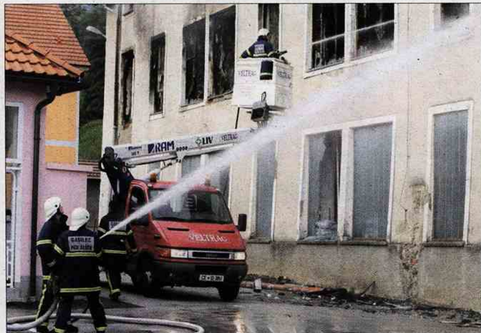
Požar se je bliskovito širil po več kot sto-let stari stavbi z lesenimi stropi, ki so se nevarno udirali. Zaradi strojev za tkanje, premazanih z oljem in mastjo, se je ustvarjala peklenska vročina. (Foto: Franc Verdel)
