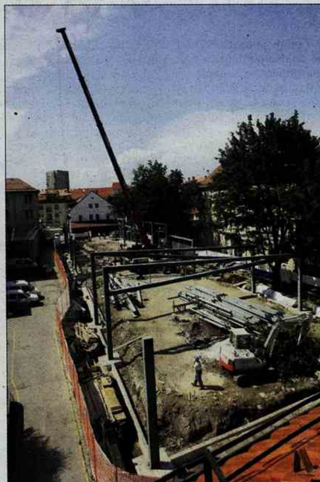
Pogled na izpraznjeno gradbišče celjske tržnice 30. julija, ko se je zgodila tragična nesreča.
