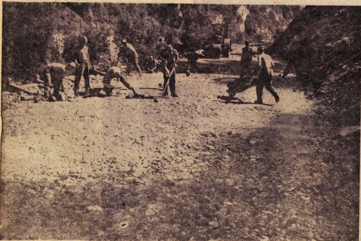
Spodnji ustroj cestišča je treba zdaj še nekajkrat poveljati. Pa tudi potem še ne zmanjka dela. Tu in tam je treba vložiti še kamenje, da bi bilo cestišče kar najboljšo
