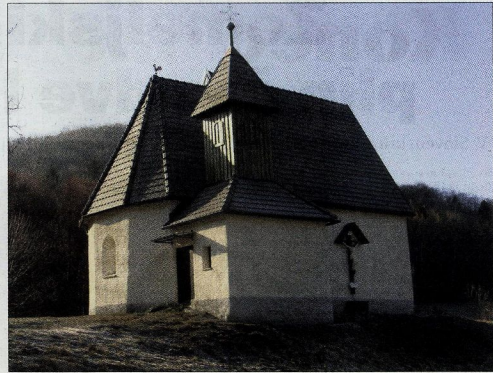
Razlika je očitna. Po nestrokovni obnovi cerkve so obnovitelji, brez vednosti spomeniškega varstva, kamniti skrilavec zamenjali z zareznim bobrovcem, pa tudi fasado so obnovili po svoje.
