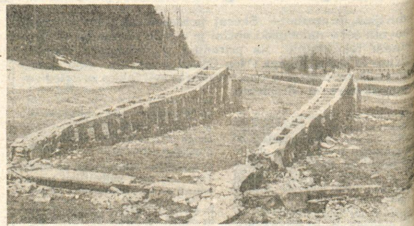
Nov daljnovod do Jesenic — Delavci Dalekovoda iz Zagreba podirajo betonske stebre starega daljnovoda od Kranja do Jesenic, na isti trasi bodo postavili novega — jekleno konstrukcijo novega, dvosistemskega 400-kilovoltnega daljnovoda, ki bo oskrboval z električno energijo novo jeseniško elektrojeklarno. Investitor so Savske elektrarne, predračunska vrednost znaša 806 milijonov dinarjev. Foto: F. Perdan
