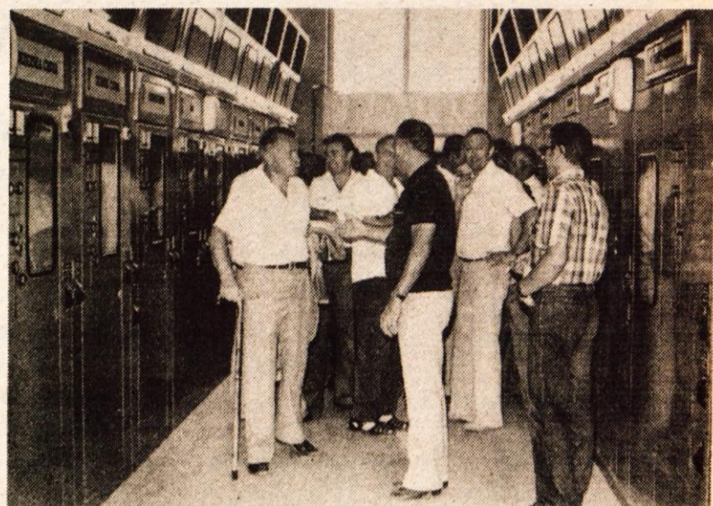
Predsednik izvršnega sveta skupščine občine Kranj inž. Drago Stefe je v sredo dopoldne v počastitev občinskega praznika prerezal trak nove razdelilne transformatorske postaje Primskovo. S tem je bila končana sicer šele prva etapa, saj bo treba v prihodnjih letih dograditi še transformacijo. Za novo razdelilno postajo na Primskovem se je bilo treba odločiti zaradi novih močnih odjemalcev električne energije, kot so komunalna cona in pa stanovanjski kompleks na vzhodni strani mesta, prav tako pa tudi tovarna IBI, RTC Krvavec in nova naselja severno od Kranja. Z novo postajo bo tudi letališče Brnik dobilo s posebnim kablom lasten in tudi kvalitetnejši dovod električne energije. Nova razdelilna postaja je veljala 32 milijonov din. Gradbena dela je opravilo SGP Gradbincev Kranj, elektromontažna dela pa Elektro Kranj. Postaja poskusno obratuje in so vse naprave že pod napetostjo. Investitor je bila delovna skupnost Elektro Gorenjska. – Foto: F. Perdan
