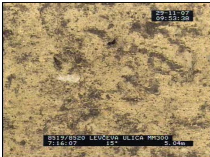
Slika 9 • Prikaz kolonij biofilma na cevi s TV-kamere (Panjan, 2008)
