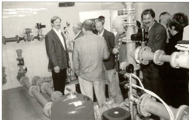
Ogled notranjosti prečrpališča v Narapljah.
