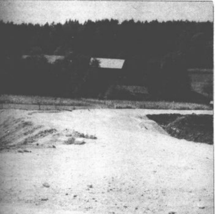
Novi odsek ceste Škale - Gaberke, katere investitor je REK Velenje, bo dolga 2200 metrov, široka pa 6 metrov. Izvajalec del je TOZD Zunanji obrat v kooperaciji s Komunalnim centrom. Ponedeljek so asfaltirali prvi odsek, dolg 400 metrov, te dni pa z nadaljevali. Investicijska vrednost te ceste znaša 25 milijonov dinarjev.
