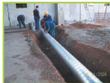
Kanali za odvod iz odsesovalnih kanalov v livnicah
