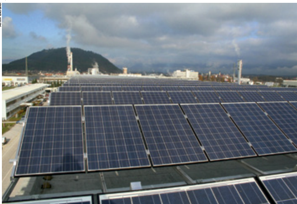
Trenutno največja sončna elektrarna na Gorenjskem na strehi Iskratela.
