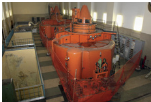
Strojnica brez generatorja 3.
