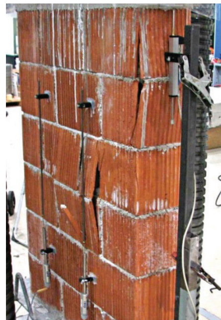
Slika 3 • Tlačna porušitev preizkušanca.
