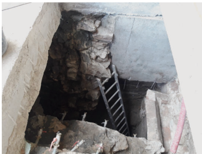
Slika 10 • Izkop globljih vertikalnih kampad, vidni so injekcijski nastavki, preko katerih se je injektiralo med izkopi odkrito kamnito-opečno gradivo.
