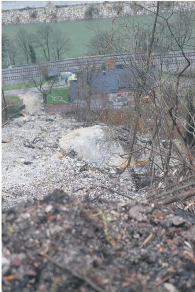
Takole grozeče je bil plaz videti konec lanskega novembra. Danes hišo pred skalami in zemljo varuje tako imenovana palisadna stena. Nadaljnja sanacija pa je po besedah Marjana Stopinška iz Slovenskih železnic odvisna od poslaha države.
