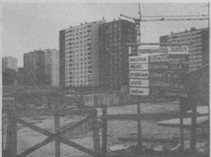
OSNOVNA ŠOLA V ŠTEPANJSKEM NASELJU — Čeprav jo Štepanjci že težko pričakujejo, bo nova šola zgrajena šele julija prihodnje leto, tako kot je bilo v načrtih tudi predvideno Foto K. HVASTIJA
