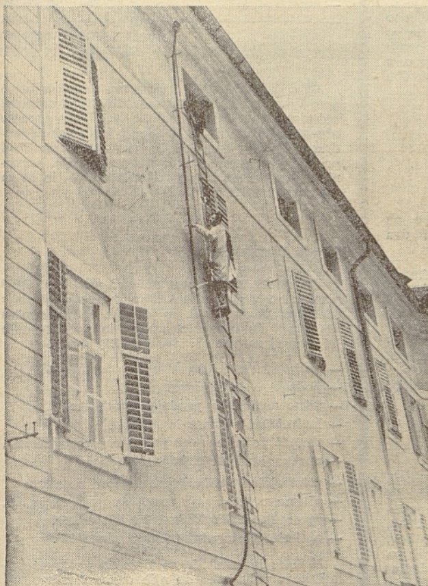
Pritrditev valovoda na konzole na zunanjo steno zgradbe Štrosmajerjevega doma v Rogaški Slatini. Na strehi je postavljena parabolična antena v premeru 3 m
