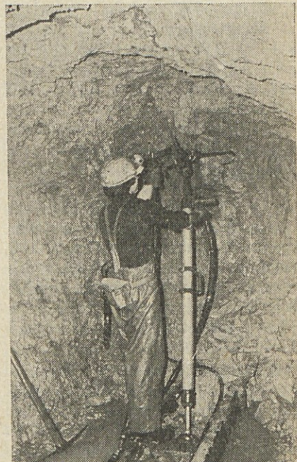
Izdelovanje proge v dolomitu v jami Ojstro. Dela izvaja TOZD Rudarske investicijske gradnje. f. A. Bregant
