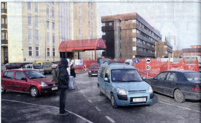
Obvoz ob gradbišču na Mariborski, ki je zdaj do 4. septembra povsem zaprt, je vsaj malce bližji prometno gnečo v Celju.
