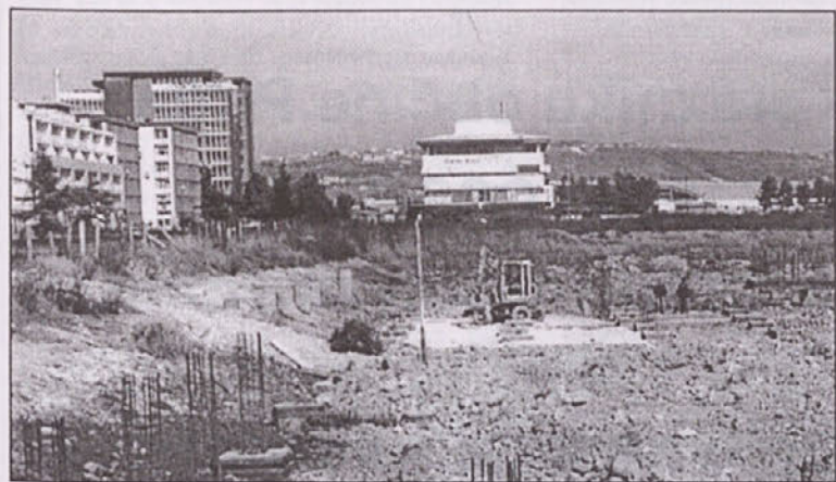
Na sliki: Izkopi ob Ferrarski cesti v Kopru. Tu naj bi zrasel velik poslovno-trgovski objekt Toncity.
